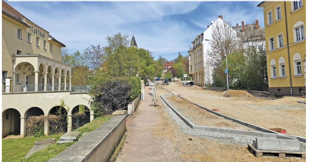
Seit Ende Februar 2026 ist die Rosa-Luxemburg-Straße zwischen dem Abzweig Ritterstraße und der Kreuzung Staupitzstraße voll gesperrt. Die Bauarbeiten liegen im Zeitplan. Während des Heimatfestes soll die Straße nutzbar sein. Anschließend beginnt der zweite Bauabschnitt zwischen dem Abzweig Staupitzstraße und der Kreuzung Otto-Johnsen-Straße. Foto: M. Fricke
