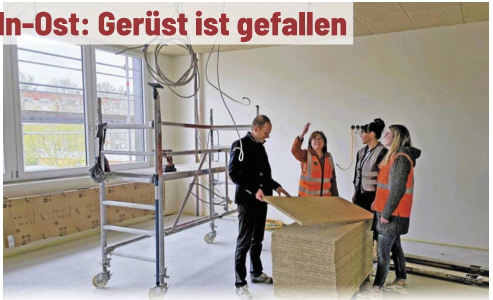
Die Architekten Christian Müller (li.), Sabrina Mechelke (2. v. re.) und Lisa-Marie Isensee (rechts) von O+M Architekten aus Dresden begutachten mit Regina Hlozek vom Bauamt der Stadtverwaltung die Deckendämmung in den zukünftigen Klassenräumen. Diese besteht aus gepressten Holzwolleplatten. Fotos (7): Maria Fricke
