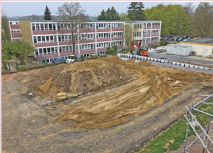
Mit dem Wegfall des Gerüsts können nun auch die Arbeiten im Außenbereich, hier der Schulhof mit der bisherigen Schule, fortgesetzt werden.
