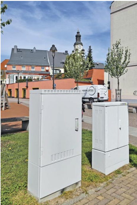
Frisch gereinigt und mit einem speziellen Anstrich versehen worden sind unter anderem diese Stromkästen an der Döbelner Zwingerstraße. Foto: Maria Fricke
