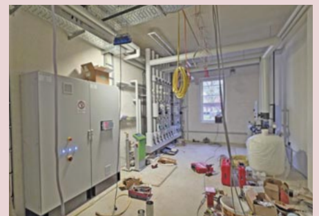
Herzstück der Nahwärmeversorgung der neuen Grundschule durch die Stadtwerke Döbeln GmbH – der Heizraum des Neubaus.
