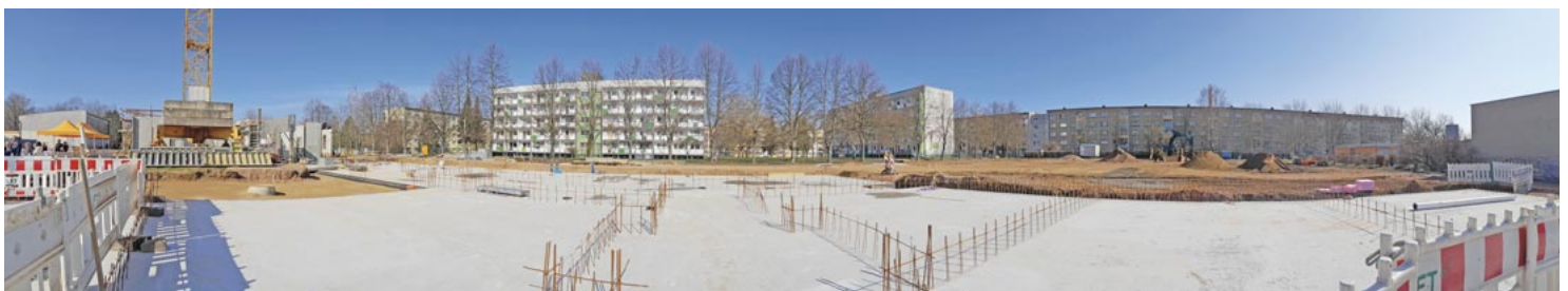
Auf dem ehemaligen Sportplatz der Grundschule Döbeln-Ost entsteht derzeit für rund 17,6 Millionen Euro ein neues Schulgebäude. Die Erschließungsarbeiten sind abgeschlossen, die Bodenplatte ist fertig, die ersten Wände stehen bereits (links). Bis Ende 2026 soll das Schulgebäude fertig sein. Der Freistaat unterstützt den Bau mit 8 Millionen Euro. Foto: Maria Fricke
