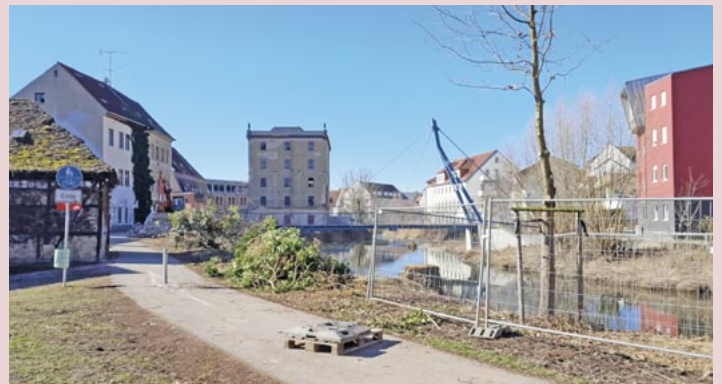
Am 3. März 2025 haben im Umfeld des Staupitzstegs die Bauarbeiten zum Hochwasserschutz begonnen. Bis voraussichtlich Ende Mai 2025 bleibt der Staupitzsteg daher voll gesperrt. Fußgänger und Radfahrer werden gebeten, auf den Steg Breitscheidstraße beziehungsweise auf die Oberbrücke auszuweichen. Foto: Maria Fricke
